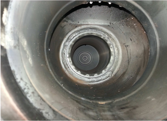
Asiento dañado (F), dentro de la válvula Fuente: 20131124_132438
